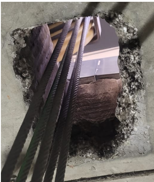
Abbildung 6: Aufzugsseile Gebäude BGR 06
