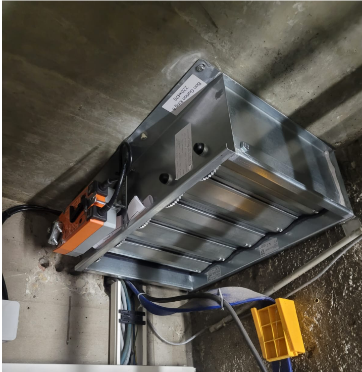
Abbildung 2: Entrauchungsklappe im Gebäude BGR 6
