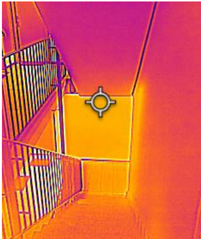
Abbildung 15: Aufnahme Wärmebildkamera Gebäude 04
