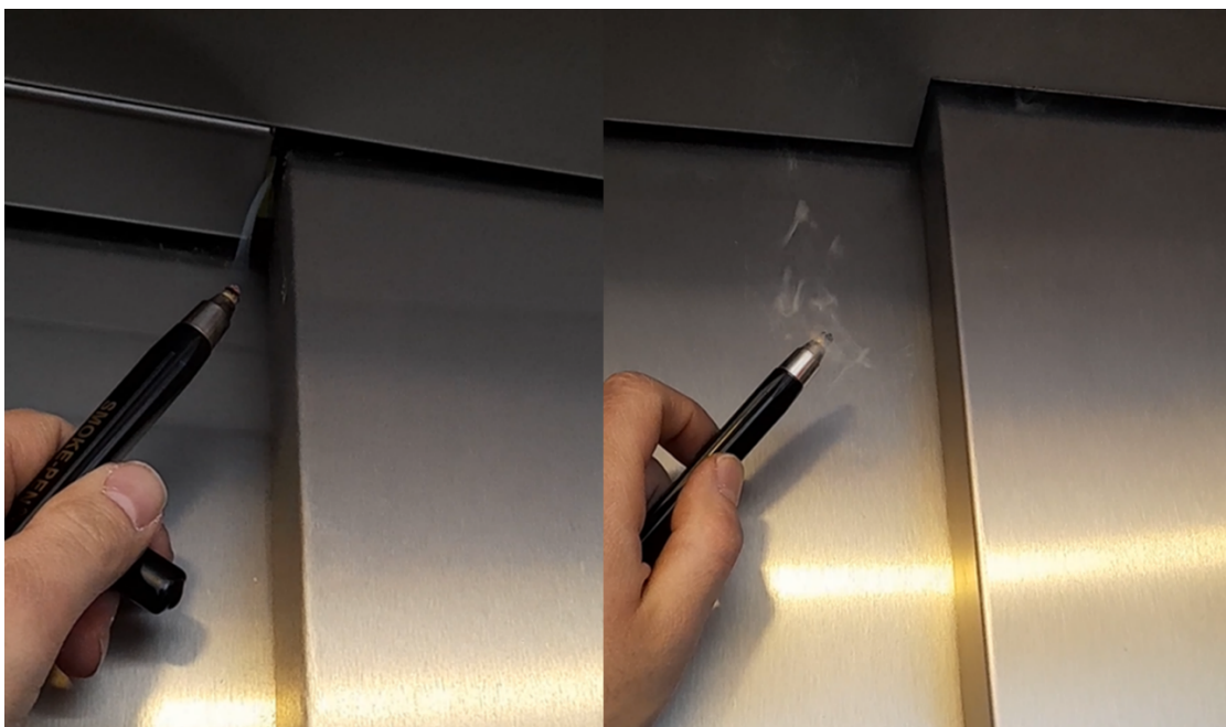
Abbildung 16: Luftströmung an Aufzugstüren. Links Gebäude BGR 6 (keine Klappe vorhanden) u. rechts Gebäude BGR 4 (Klappe geschlossen)
