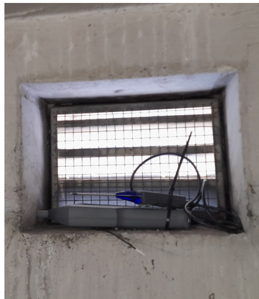
Abbildung 5: Lüftungsgitter im Technikraum von Gebäude BGR 06
