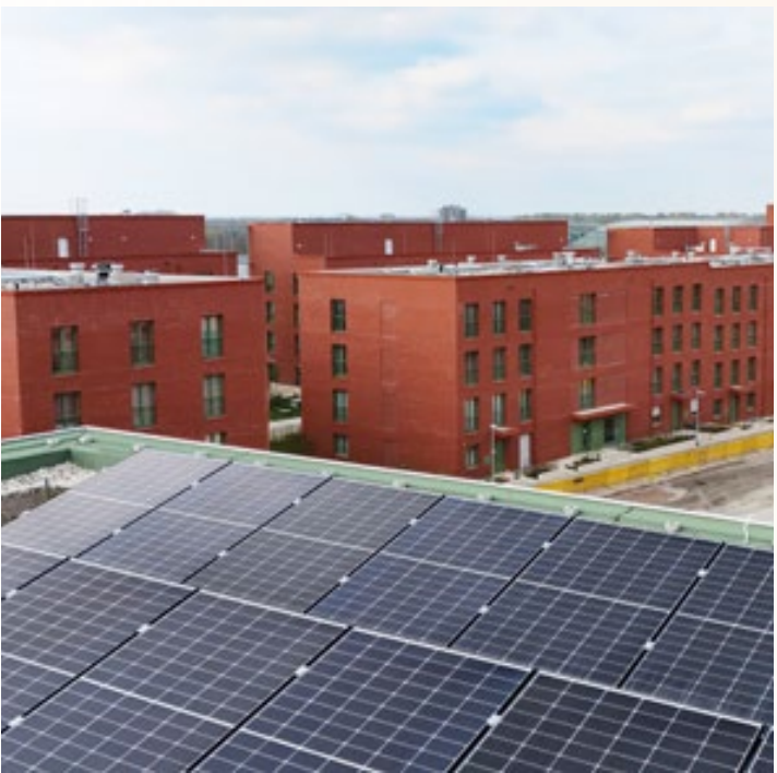
PV-Aufdachanlagen im GWH Quartier NordKrone
